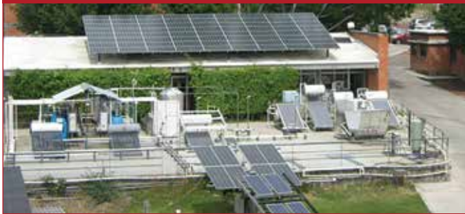
Figura 7. Planta fotovoltaica de 10 kWp, Instituto de Energías Renovables, UNAM, Temixco, Morelos
