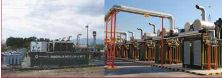
Figura 20. Planta de generación de electricidad de 5.3 MW a partir del biogás producido con residuos sólidos urbanos de la ciudad de Monterrey, Nuevo León
