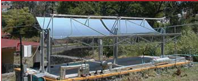
Figura 13. Módulo de concentrador solar parabólico para calor de proceso industrial, Instituto de Investigaciones Eléctricas
