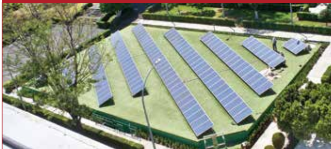
Figura 9. Central solar fotovoltaica MUTEK de 30 kWp, CFE, Ciudad de México
