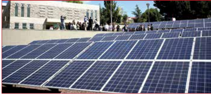
Figura 10. Planta fotovoltaica interconectada a la red del proyecto UNDP/GEF-IIIE de 180 kWp, Zacatecas
