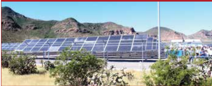
Figura 8. Central solar fotovoltaica “Santa Rosalía” de 1 MWp, CFE, Baja California Sur
